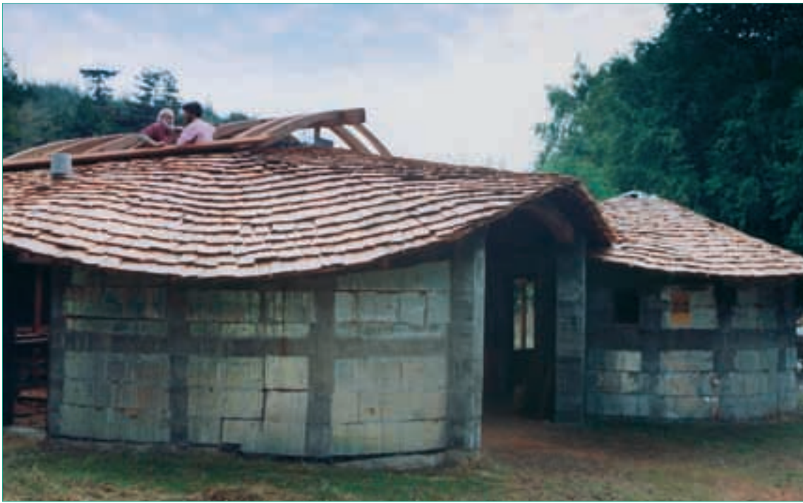
Le toit est couvert d'écailles de bois rouge; Louie et Rufus construisent l'encadrement du toit vitré.
