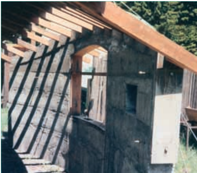
Il y a une poutre continue sur la ceinture supérieure comprenant quatre barres en acier de 13 mm en haut du mur. Sur les chevrons, des pointes en acier traité ont été clouées de biais; puis ceux-ci ont été incorporés dans la poutre sur la ceinture supérieure. Du béton a été ensuite coulé entre les chevrons.
