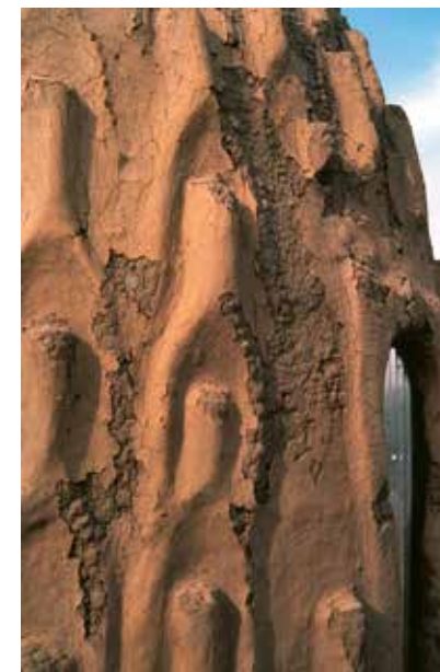
Détérioration d'une case obus construite à l'époque de Dana Goodhue, c. 1994.
